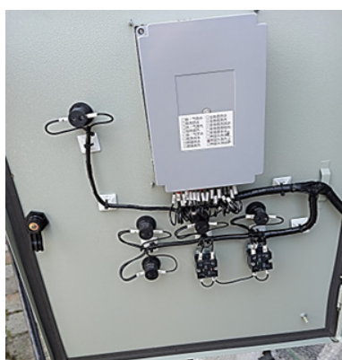
Figura 9.28. Vista de conexiones de controlador, selectores, indicadores luminosos
