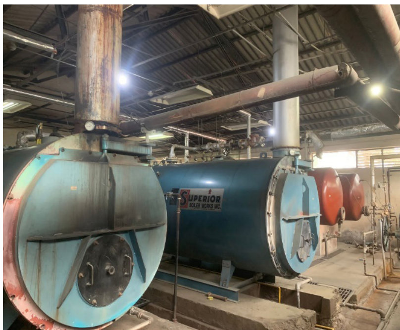
Figura 12.1. Estado de la planta y línea de vapor del HMYM.
