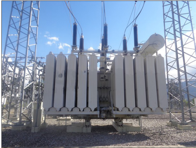
Figura 7.4. Autotransformador de la SE Loja de Transelectric
