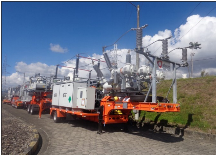
Figura 7.5. Subestación móvil instalado en la SE Loja
