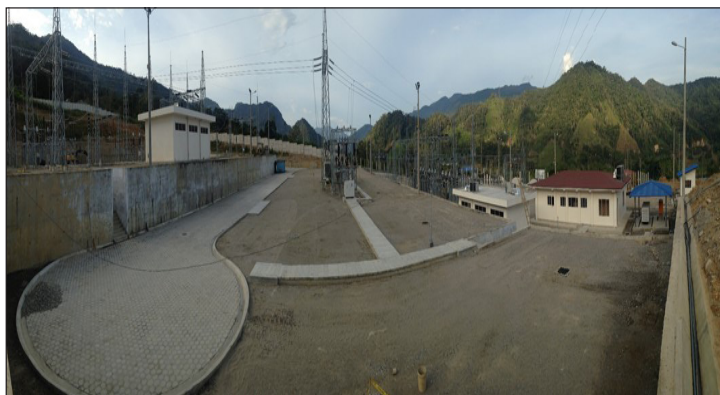
Figura 7.6. Nueva SE Cumbaratza. Fuente. Celec EP-Transelectric.
