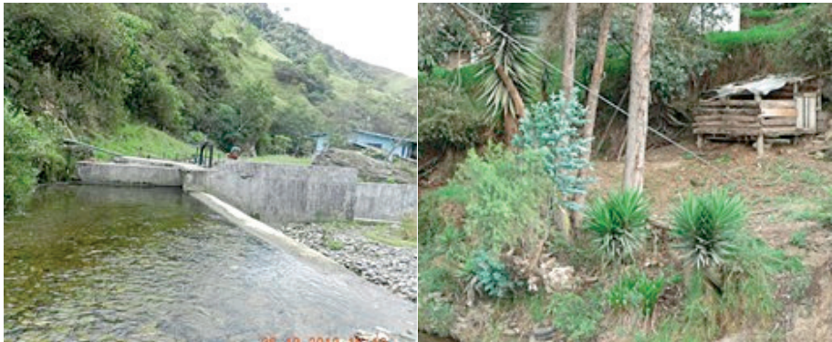
Figura 4. Deterioro de las instalaciones de agua potable de la microcuenca Jipiro
